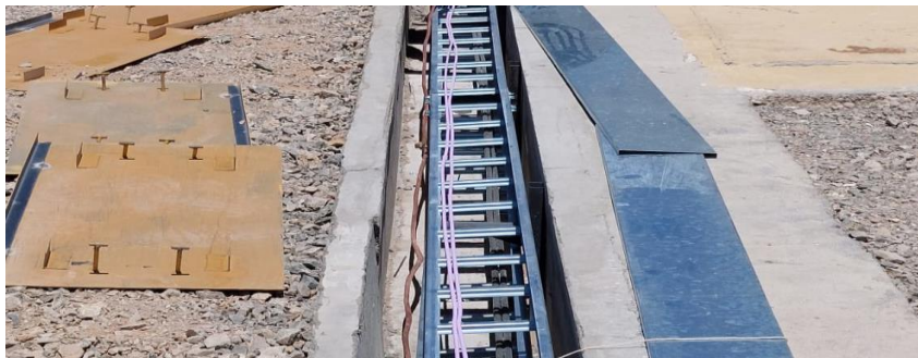
Zdjęcie 1 Dukt na przewody elektryczne z drabinkami montażowymi
